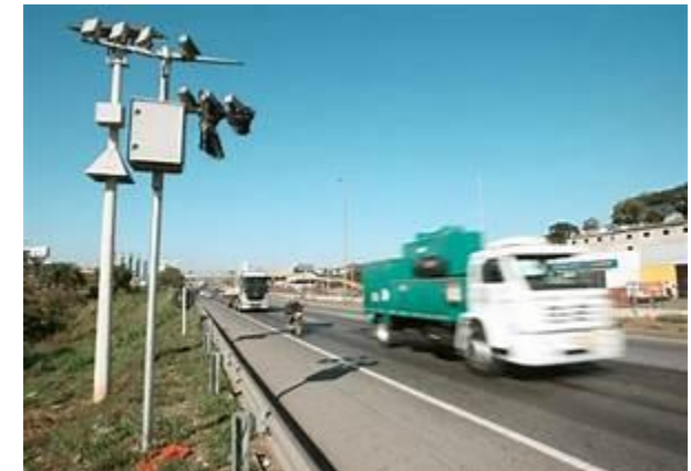
SENSOREAMENTO DE TRAFEGO
